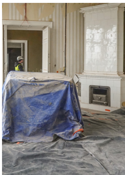
Zabytkowe wnętrza pałacu wymagają wielu prac remontowych
